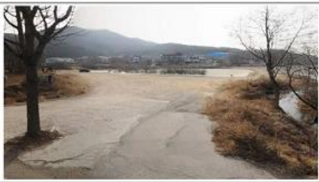
▲ 훼손현황(불필요한 콘크리트 포장)
